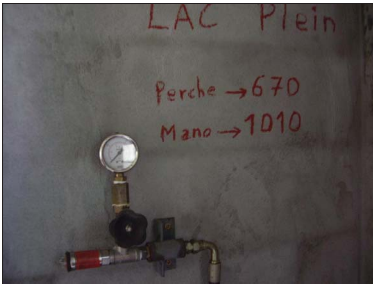
Manomètre de mesure du niveau d'eau dans la « cabane du pêcheur » (graduations tous les 0.05 bars soit 50 cm d'eau) – 06/06/11
